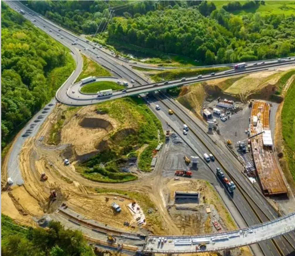
Assemblée sur place, la charpente métallique du viaduc est sera posée dans la nuit du 12 au 13 juin avant d'être bétonnée. © Photo Gael A
