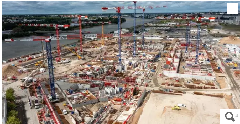
Le chantier du futur hôpital, sur l'île de Nantes, impressionnant, respecte pour l'instant les délais. Mais les coûts s'envolent. © Franck Dubray / Ouest France
