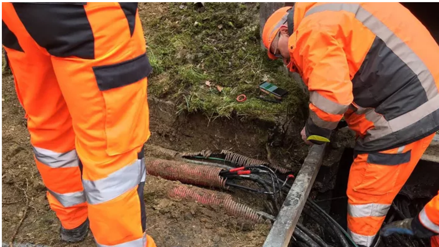
Deux coffrets contenant plusieurs centaines de câbles électriques ont été ouverts. HANDOUT / AFP
