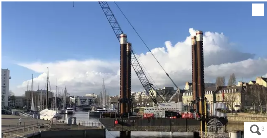
Une immense barge du groupe Eiffage a la lourde charge d'ancrer en force des pieux à l'avant-port, à l'Estacade, afin de sécuriser et d'améliorer les équipements du port de plaisance de Lorient. © OUEST-FRANCE
