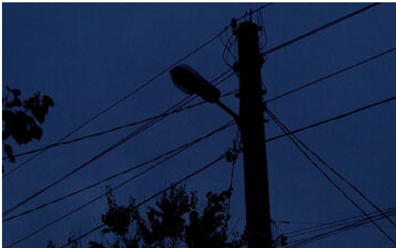
VIDÉO. L'Ukraine s'éclaire à la bougie après des frappes russes contre des centrales électriques
