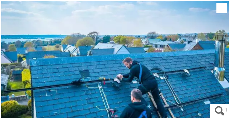
Les panneaux solaires commercialisés et installés par la société Adekwatts sont fabriqués dans deux entreprises françaises. © DR.
