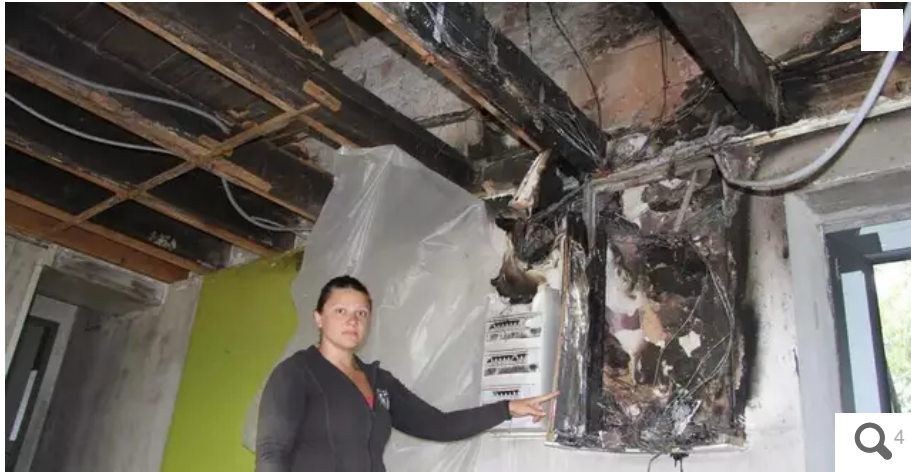
Un incendie a partiellement détruit la maison de Camille, fin février 2022. Depuis, les travaux n'ont toujours pas pu commencer. Le feu avait pris dans le compteur électrique. © Ouest-France
