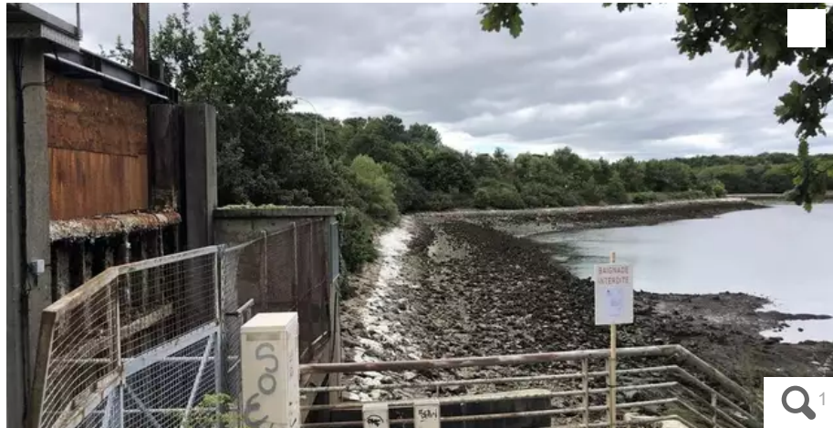
La réparation de la vanne de Kermélo (Lorient) est prévue pour la fin de l'année. D'ici là, une solution provisoire va consister à fermer la vanne à marée haute par un système de palplanche, en aval du dispositif. © Ouest-France
