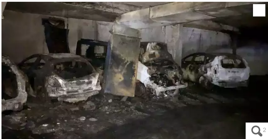
Les voitures incendiées étaient garées au fond du parking enterré de l'immeuble de la place Rosa-Parks, quartier Malakoff, à Nantes. © Ouest-France
