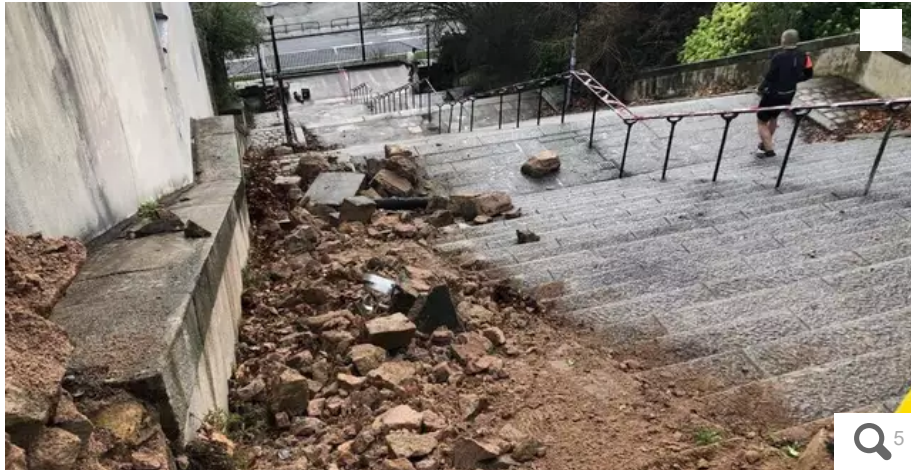
Pour éviter les risques liés aux chutes de matériaux, la mairie a pris un arrêté interdisant l'accès aux escaliers de la butte Chantenay, du côté du musée Jules-Verne. © Photo Presse Océan – RC
