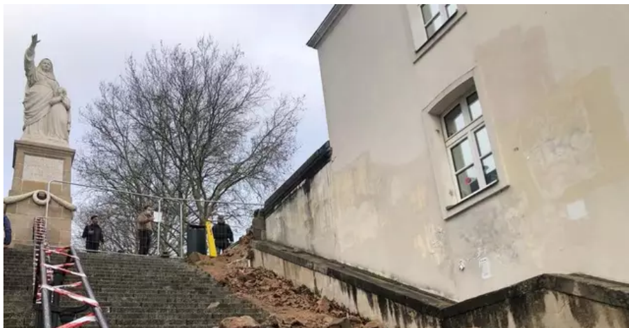
L'accès à l'escalier de la butte Sainte-Anne est désormais interdit au droit du musée Jules-Verne. © Photo Presse Océan – RC
