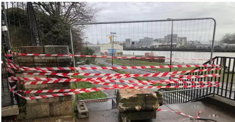
Des éléments de maçonnerie et d'un réverbère au pied de l'escalier, côté Loire. © Photo Presse Océan – RC
