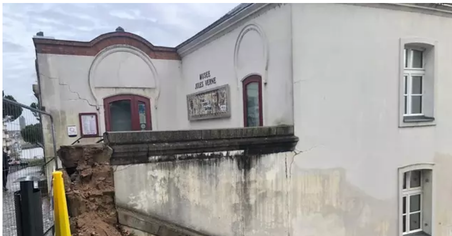
La voiture a percuté la structure de l'escalier de la butte Sainte-Anne, du côté du musée Jules-Verne. © Photo Presse Océan – RC
